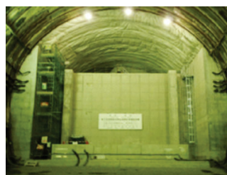
b) 地下空洞型処分施設試験設備 2)
