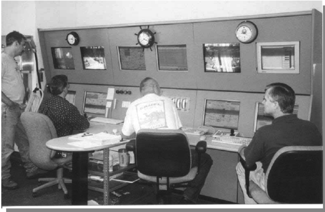
Fig. 5 スタブビック処理施設制御室の状況
