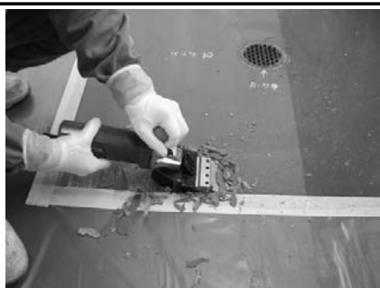
床塗装材はく離
