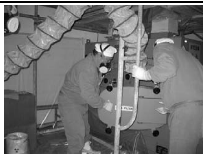
フィルタの取り出し (排気設備室)
