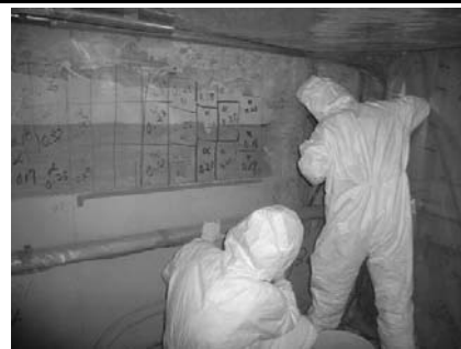
壁面はく離(汚染の除去)
