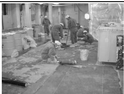
床塗装材のはく離
