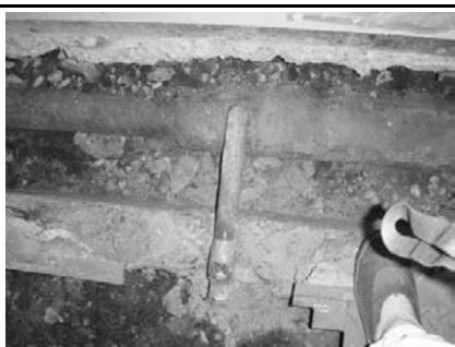
埋設が確認されたA H C F 配管
