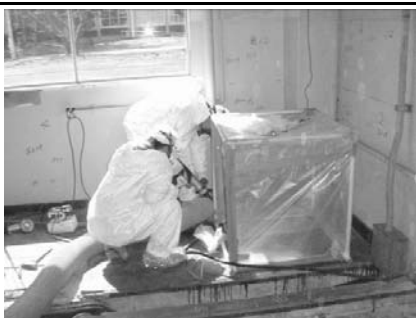
床面コンクリートはく離(汚染の除去)
