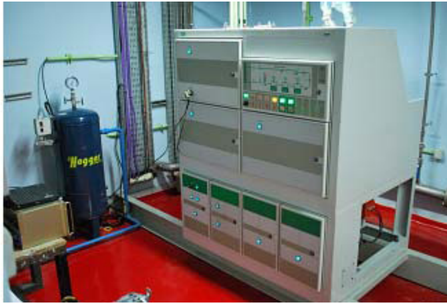
Fig. 5-9 大気放出監視システム
