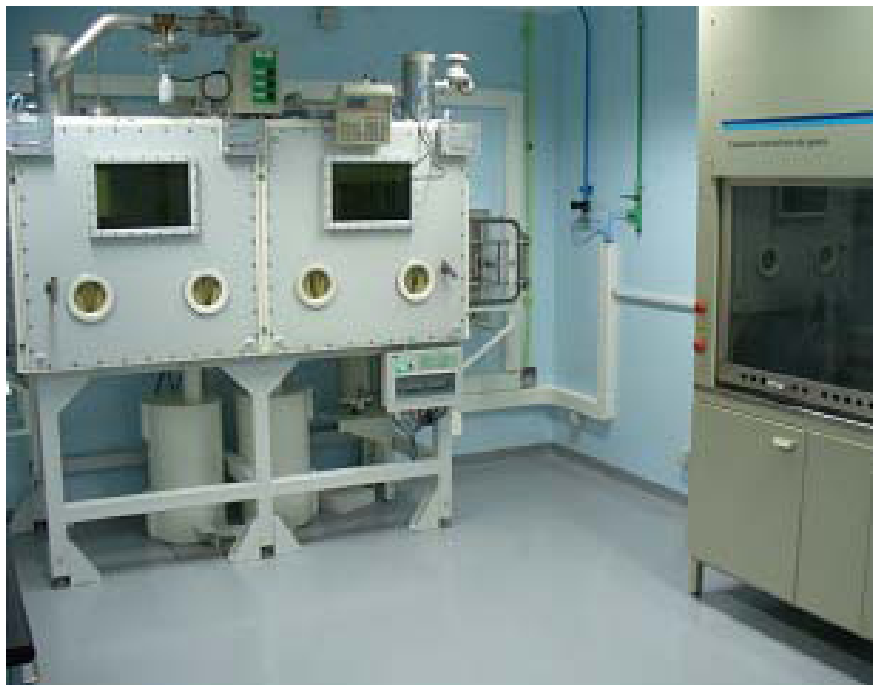
Fig. 5-10 管理ラボ室の設備
