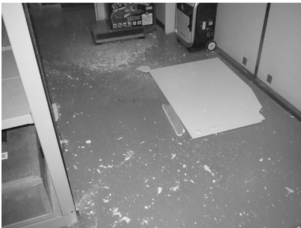
写真 2. 支援・研修センターの被災状況（資機材庫の天井板破損）
