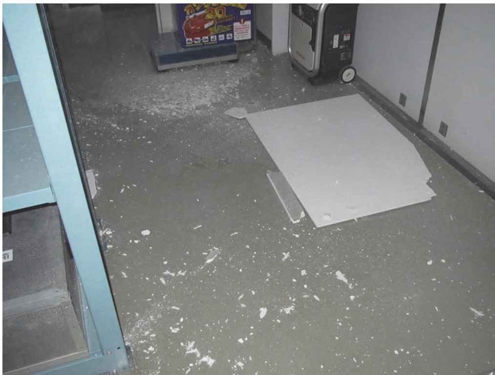
写真 3.3-16 資機材庫の被害状況(天井剥落)
