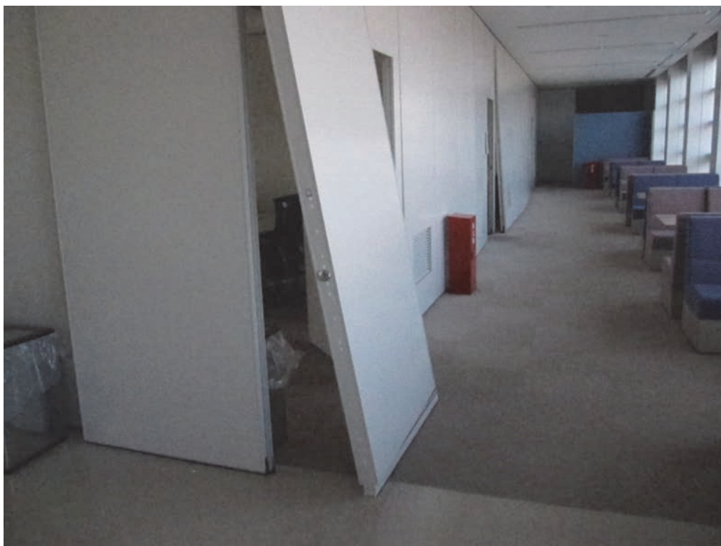
写真 3.3-17 研修棟 2 階の被害状況(スライドウォール外れ)
