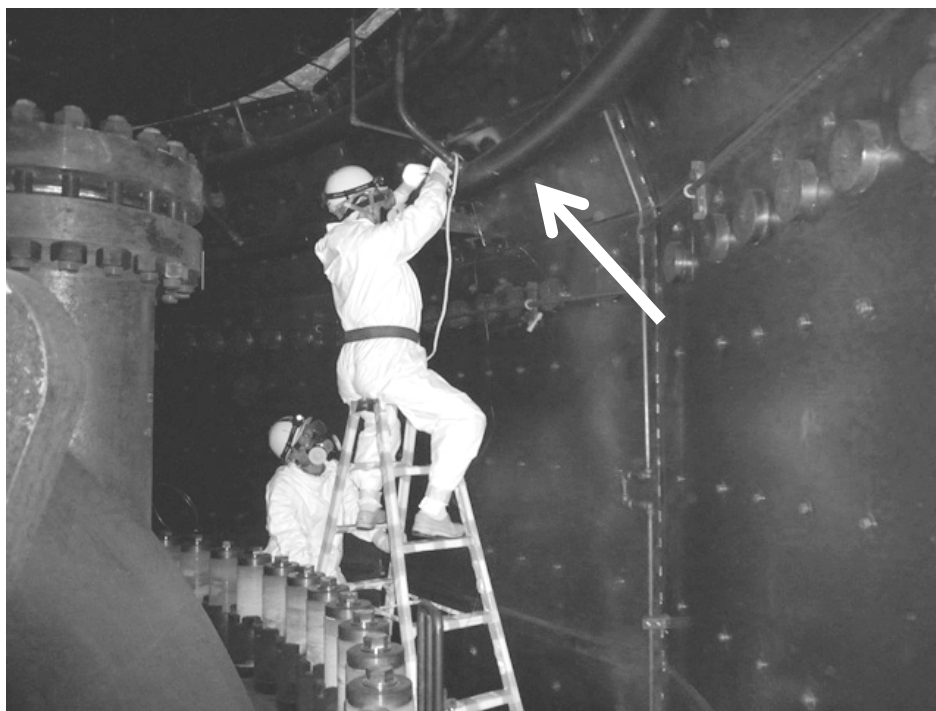
第 3.1.1 図 炉容器冷却設備側部パネル出口リングヘッド
