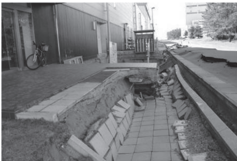
図 2.1-2 リニアック施設の被害状況(リニアック玄関前)
