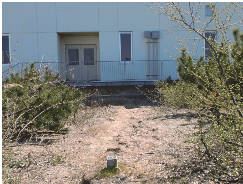
図 2.2-2 3 Ge Vシンクロトロン施設の被害状況 （物質・生命科学実験施設近傍の3-NBTの土盛り）
