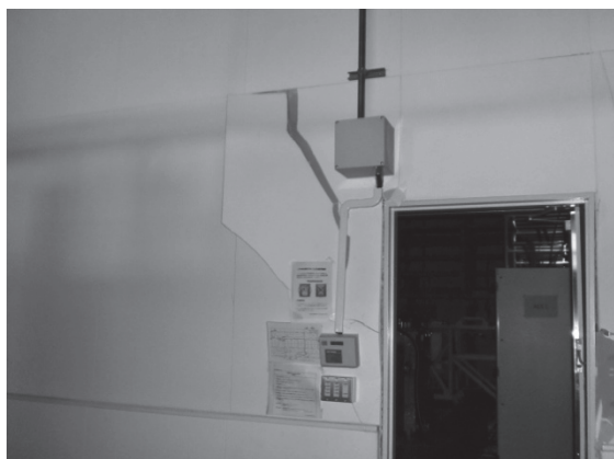
図 5.4-1 ID リーダ周辺の壁の崩落 (リニアック施設)
