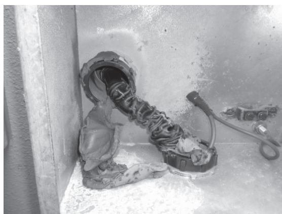
図 5.4-4 電源ケーブルの損傷 (3 GeVシンクロトロン施設)
