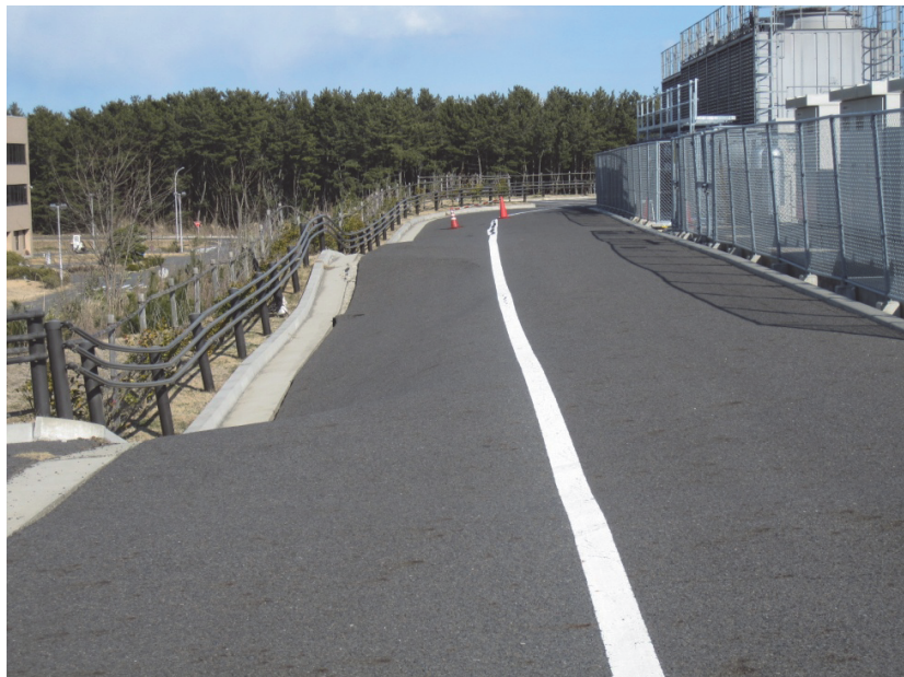
図 2.2-1 3 Ge Vシンクロトロン施設の被害状況（入射部付近の周回道路）
