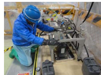
処理のための薬品注入状況
