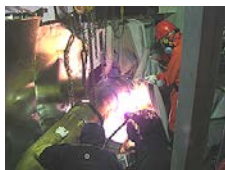
原子炉再循環系配管からの試料採取状況
