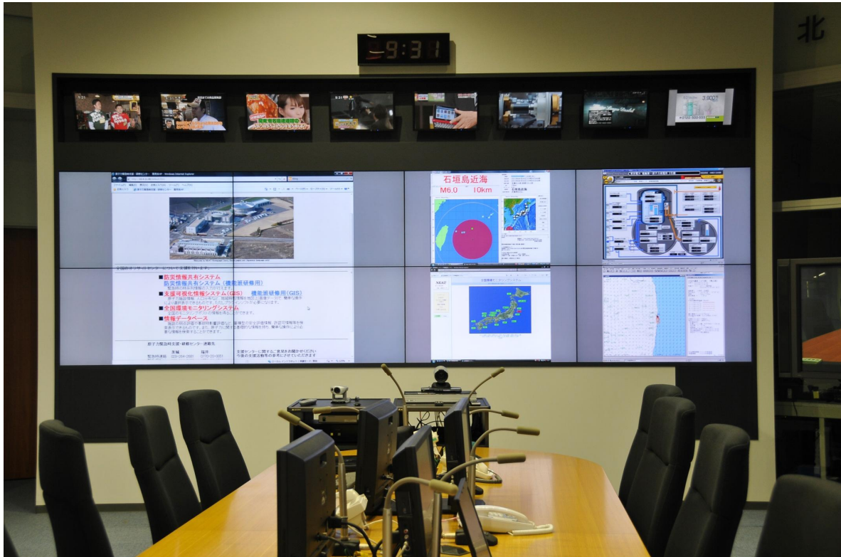
写真 7.1-1 AV設備（正面パネル）（平成 25 年 3 月更新）
