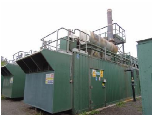
図 3.4-5 バイオガス発電機
