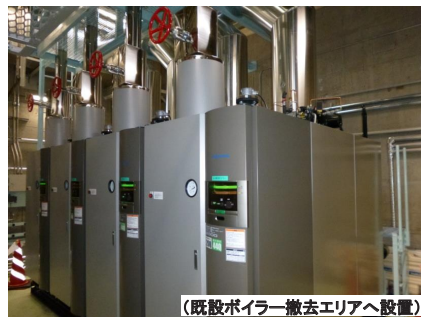
新たに設置した小型ボイラー外観
