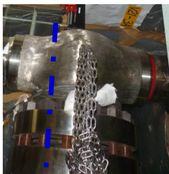
給水管逆止弁
