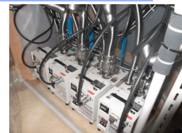
カランドリアタンク等のトリチウム除去用真空ポンプ(4台)
