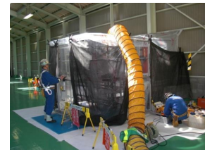
G/H設置状況
