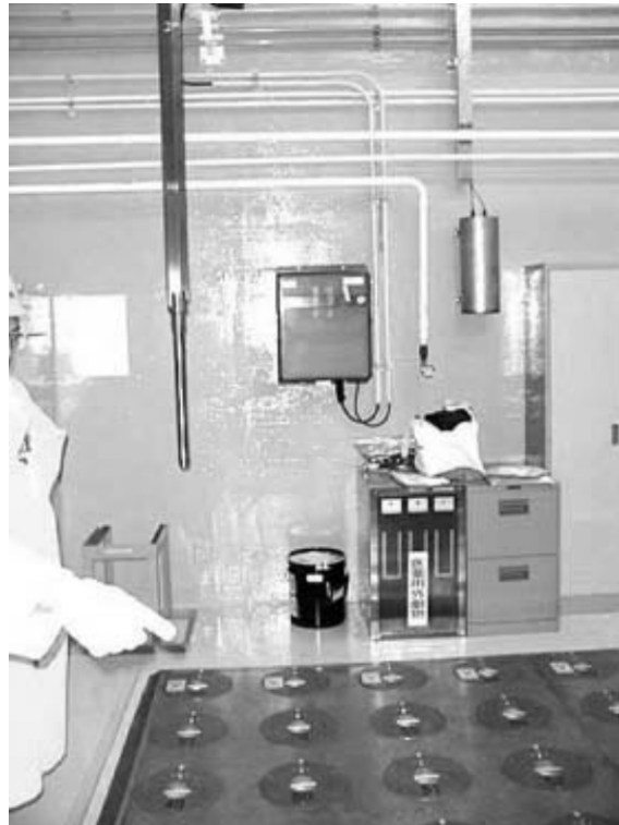
図 3.4 「常陽」新燃料貯蔵室に設置した中性子センサ
