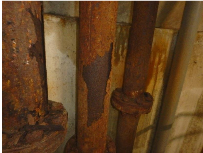
写真5.3.2-1 既設配管腐食状況（GL-250m付近） （手前から排水管、給気管、非常用給気管、通信用塩ビ管）
