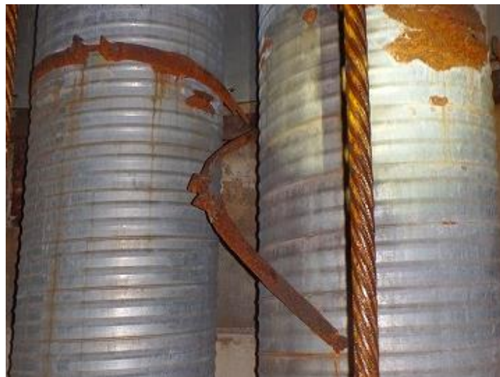
写真5.3.2-2 風管固定バンド腐食状況（GL-40m付近）
