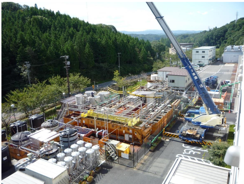
(主立坑) 排水処理設備 砂ろ過材交換
