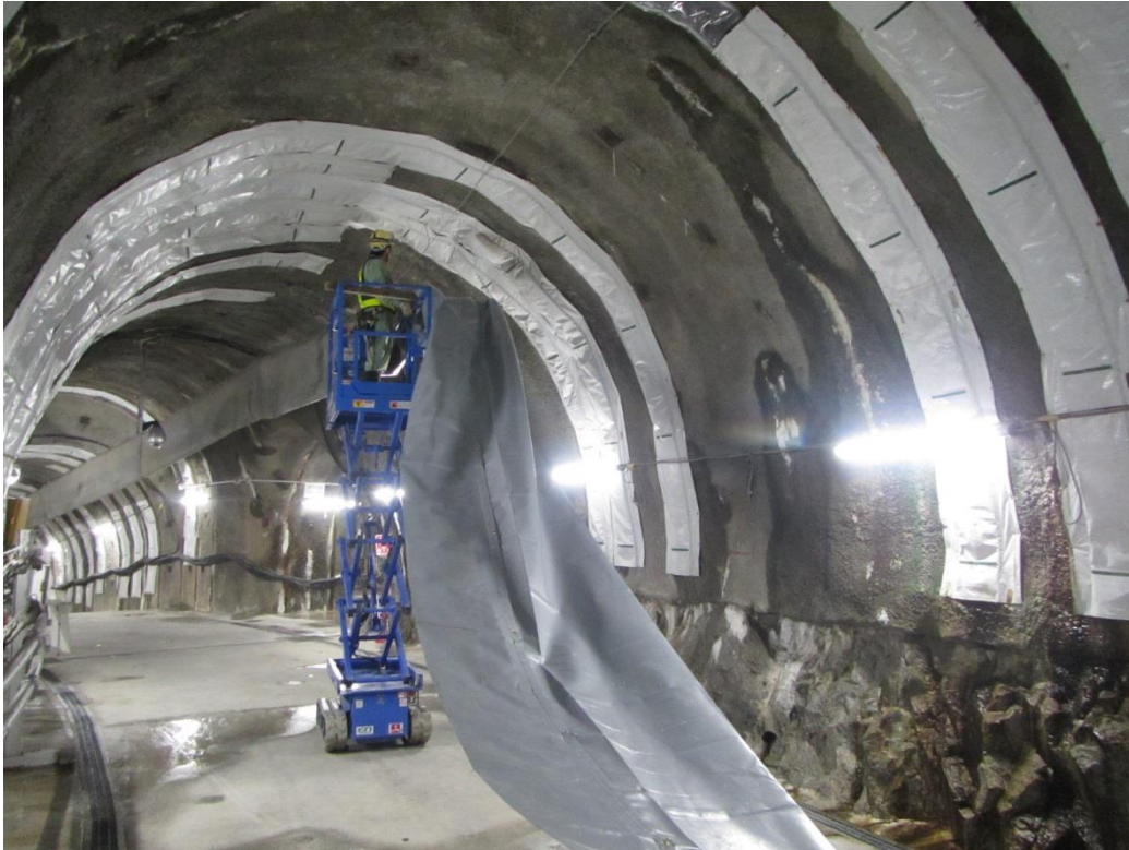
(主立坑) 坑内仮設備 深度 500m 研究アクセス北坑道 送風管交換
