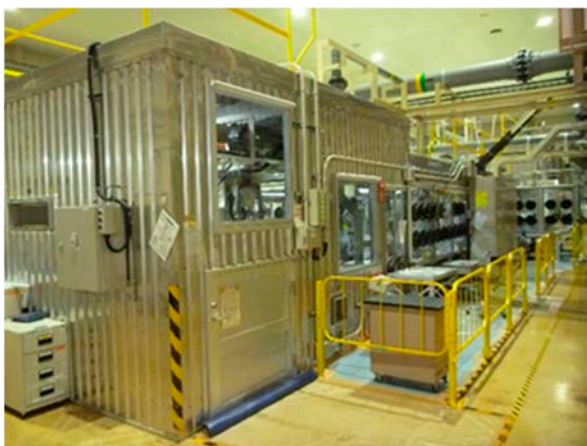
図 2.6.1-6 分解設備 (ハウス搬入部)
