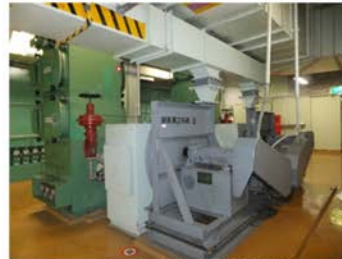
セル系排気設備
