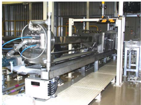
写真 2.6.1-2 大形部品除染装置（ケーシング用）
