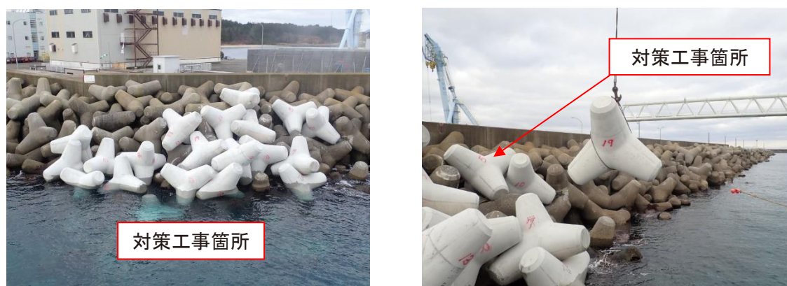
沈下が著しい護岸（I）消波工
