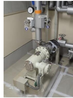
写真 1.2 モニタポンプ
