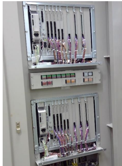
写真 2.1.2 自動制御ユニット更新後
