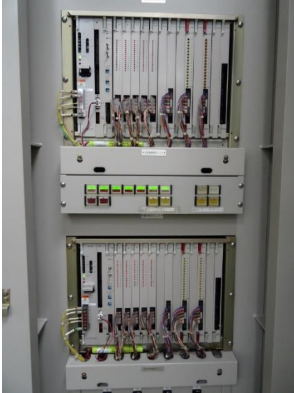
写真 2.1.1 自動制御ユニット更新前
