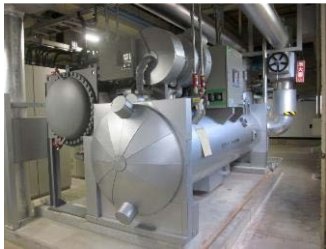
写真 2.2.12-1 ターボ冷凍機
