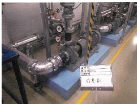
写真 2.2.1-1 ろ過水加圧送水ポンプ
