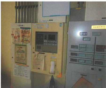
写真 2.11.7-1 放射線標準施設棟 火災受信機 更新前
