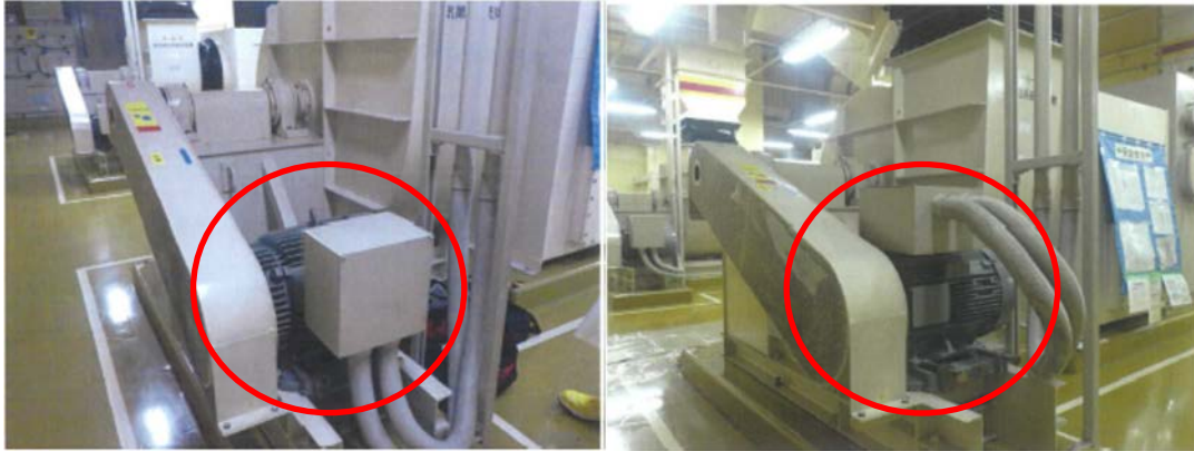
写真 2.2.7-1 電動機 更新前
