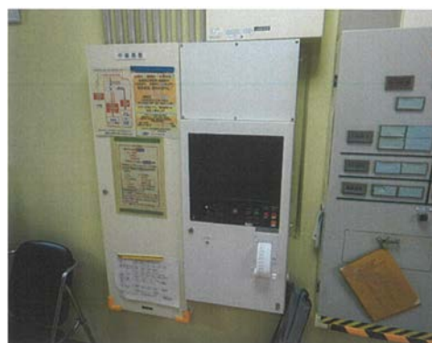
写真 2.11.7-2 放射線標準施設棟 火災受信機 更新後
