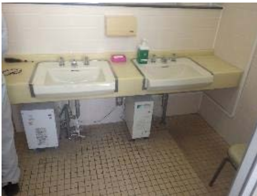
写真 2.11.8-3 洗面器水栓 更新前
