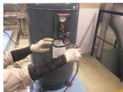
写真 2.2.1-4 タンク封入圧力の調整
