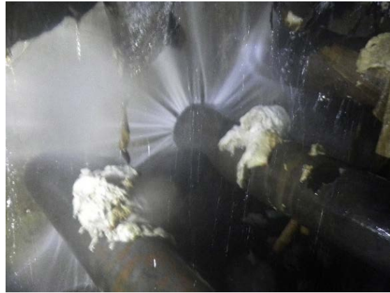
写真 2. 2. 19-2 工水配管の破断状況(壁取合部)
