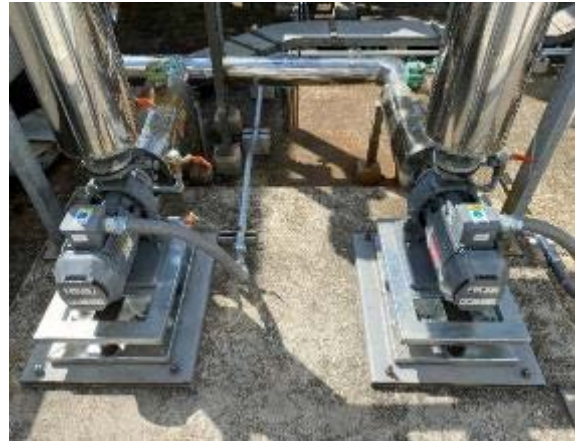
写真 2.2.10-2 温水ポンプ 更新後
