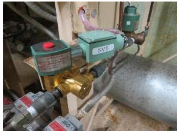
写真 2.2.5-4 電磁弁② 更新後
