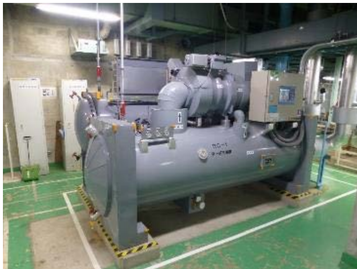
写真 2.2.8-1 ターボ冷凍機
