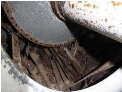
写真 2.2.2-1 羽根車フィンの脱落状況
