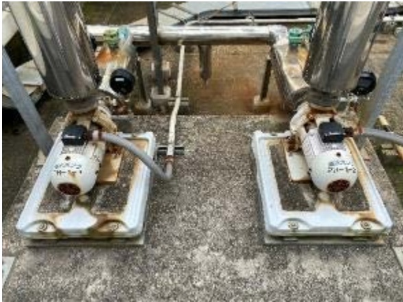
写真 2.2.10-1 温水ポンプ 更新前
