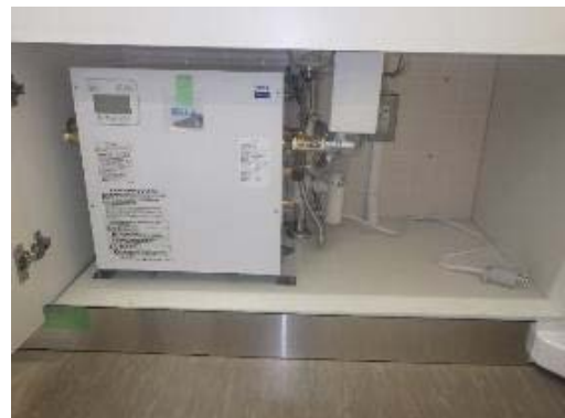
写真 2.11.8-6 電気温水器 更新後
