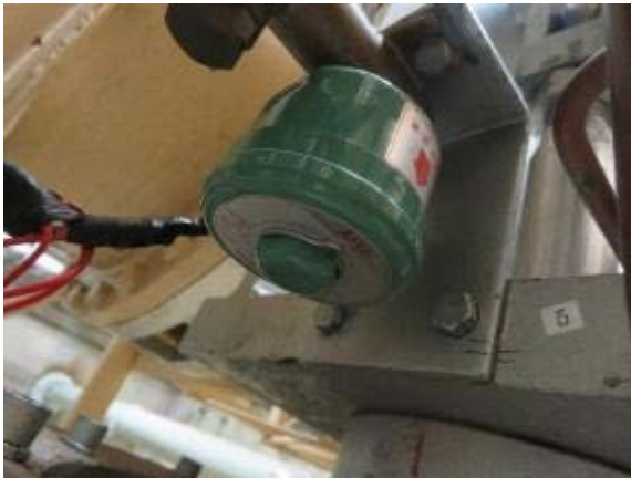
写真 2.2.5-1 電磁弁① 更新前
