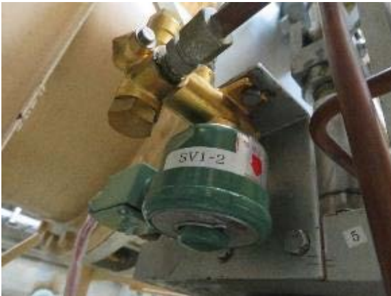
写真 2.2.5-3 電磁弁① 更新後
