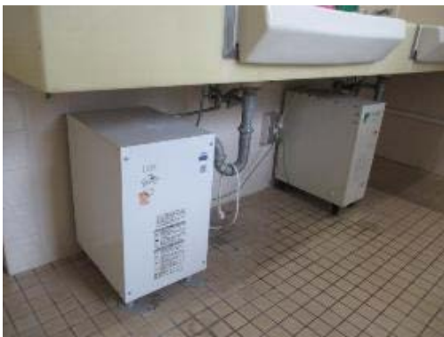
写真 2.11.8-5 電気温水器 更新前
