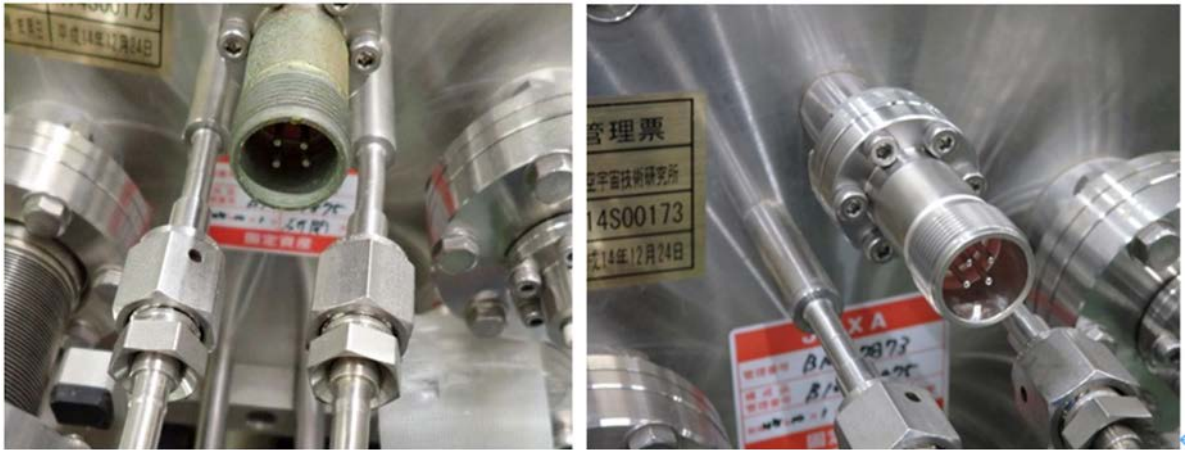
(a) 既設フィードスルー
