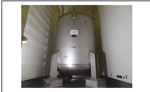
図 3.6-5 原科研バックエンド研究施設 (BECKY) の廃液貯槽室 (I)
