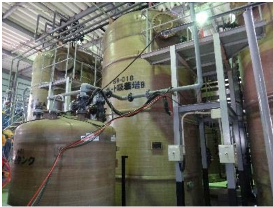
(c) 脱ホウ素設備 (1号機)
