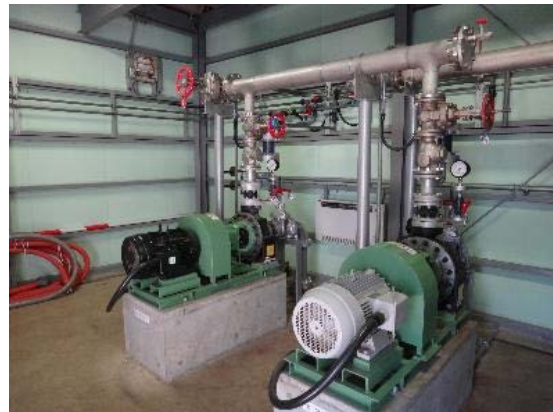
(f) 揚水設備
