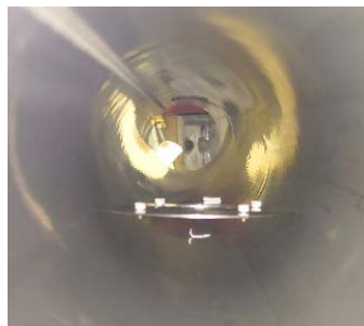
図IV-1-2 脱落していた BPM アパーチャー
