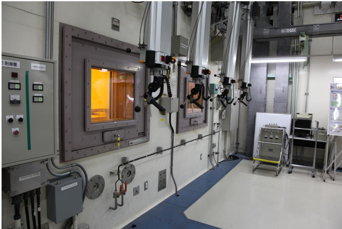
図 4 NUCEF 内に設置されたコンクリートセル設備
