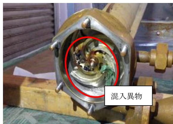
写真 2.2.5-2 ポンプ吸込口(混入異物)
