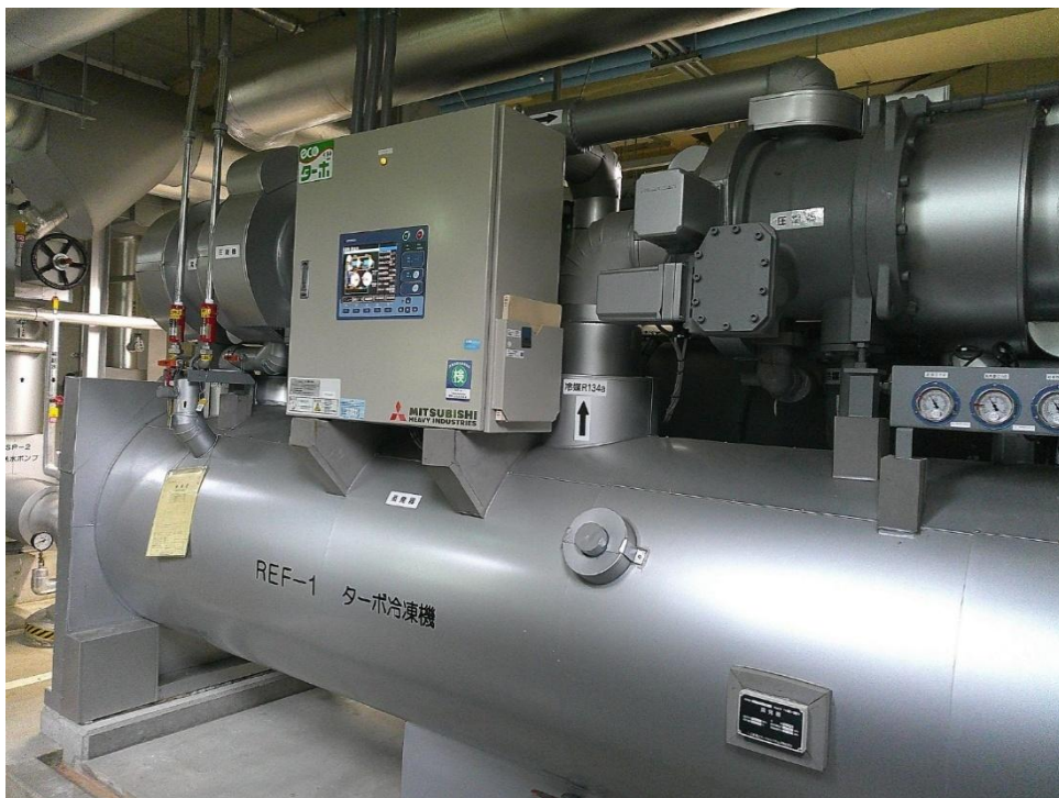
写真 2.2.12-1 ターボ冷凍機
