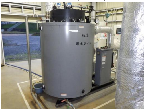
写真 2.2.18-3 温水ボイラ缶体全景(更新後)
