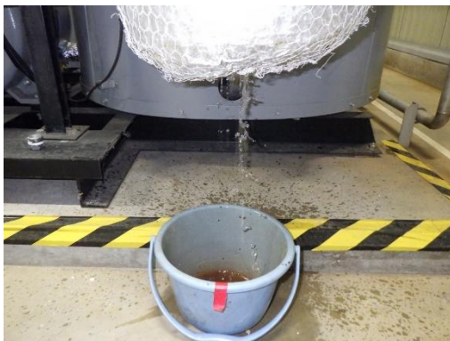
写真 2.2.18-1 煙道配管漏水
