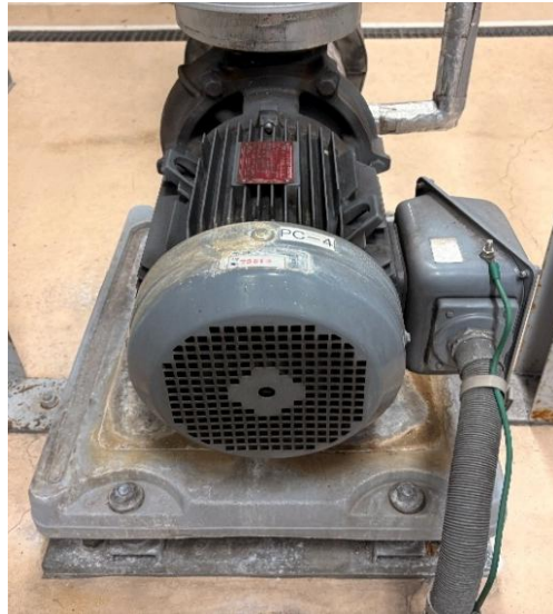
写真 2.2.10-1 冷水ポンプ(更新前)
