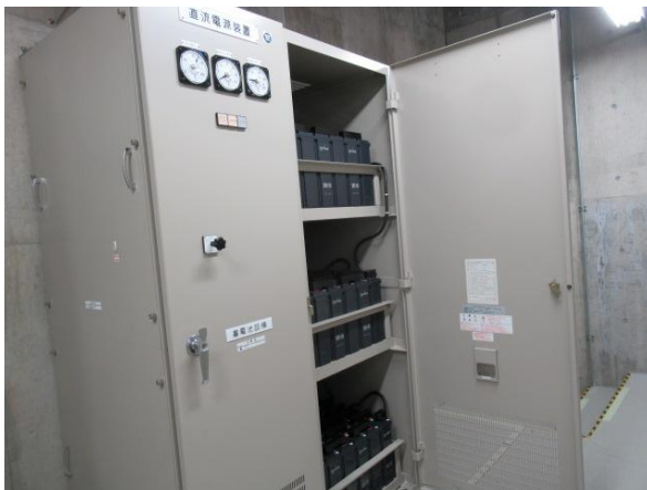
写真 2.2.14-1 蓄電池(更新前)
