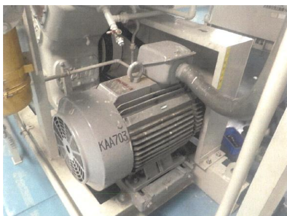
写真 2.2.1-1 電動機(更新前)
