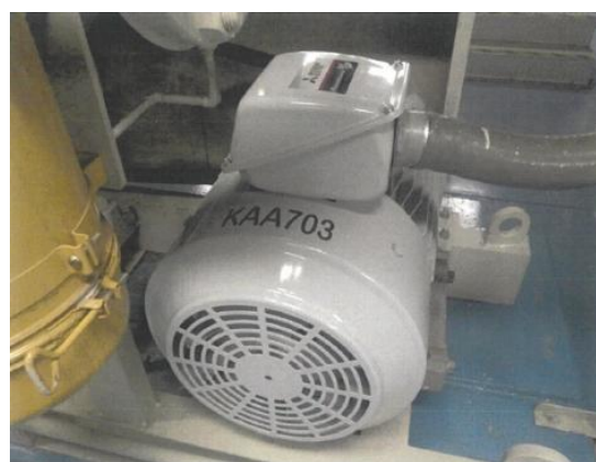
写真 2.2.1-2 電動機(更新後)
