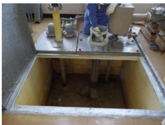
写真 2.2.5-1 ピット及びポンプ(点検中)
