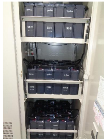
写真 2.2.14-2 蓄電池(更新後)
