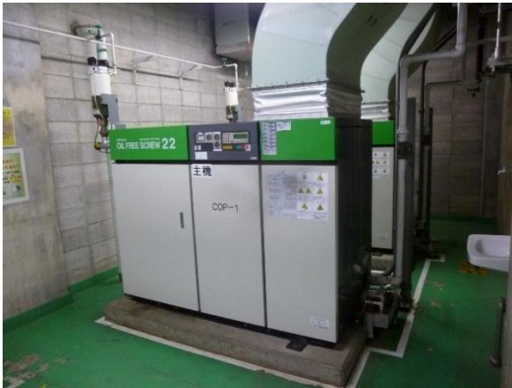
写真 2.2.8-1 空気圧縮機(更新前)
