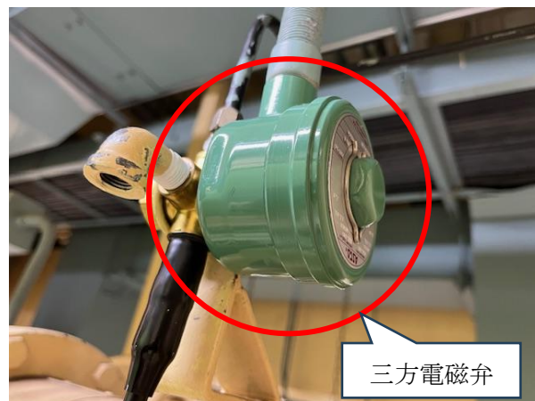
写真 2.2.6-2 三方電磁弁(交換後)
