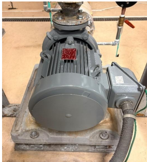
写真 2.2.10-2 冷水ポンプ(更新後)
