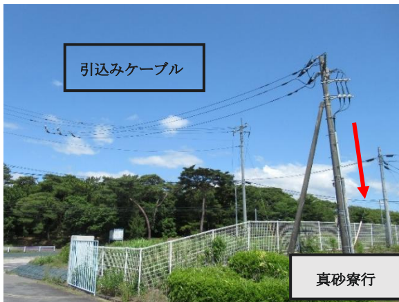
写真 2.2.17-1 引込みケーブル(撤去前)
