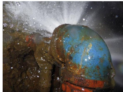
写真 2.2.18-6 工業用水配管エルボ部
