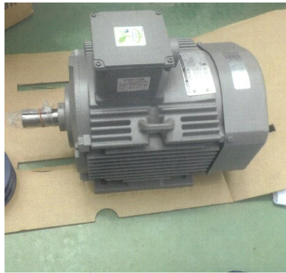
写真 2.2.9-2 冷却塔電動機(更新後)
