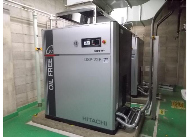
写真 2.2.8-2 空気圧縮機(更新後)
