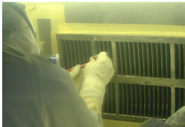
図 14 仕切り板の調整
