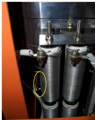
フィラメント電源 ブリッジ抵抗器(R3-1)
