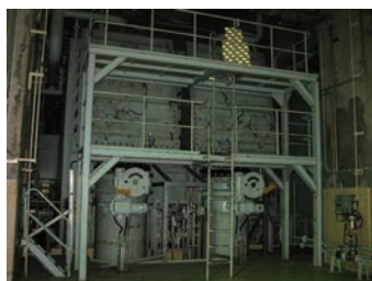
復水器冷却水入口水室
