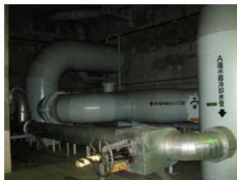
復水器冷却水(海水)配管
