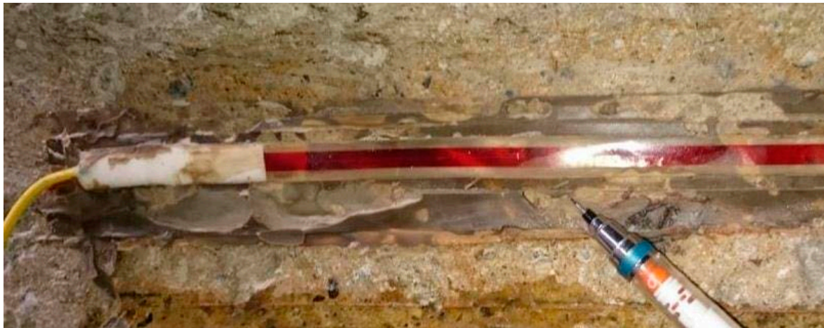
PS 剥離箇所②
