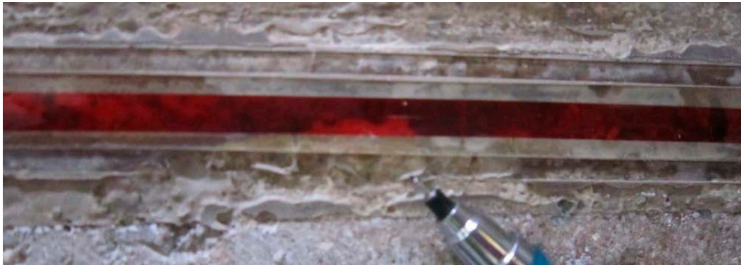
写真 5.7 PS 接着箇所の剥離部分の拡大写真 (2015 年 10 月 26 日、主立坑付近計測点)
