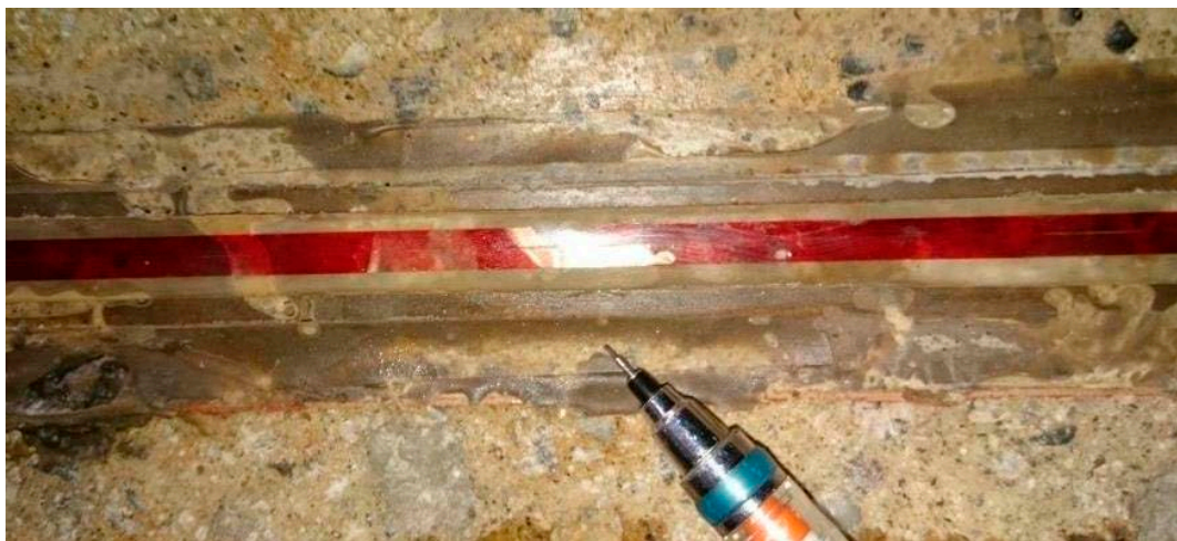
写真 5.2 PS 接着箇所の剥離部分の拡大写真 (2015 年 8 月 4 日、換気立坑付近計測点)
