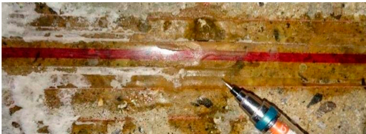
写真 5.3 EB-2 接着箇所の剥離部分の拡大写真 (2015 年 8 月 4 日、換気立坑付近計測点)
