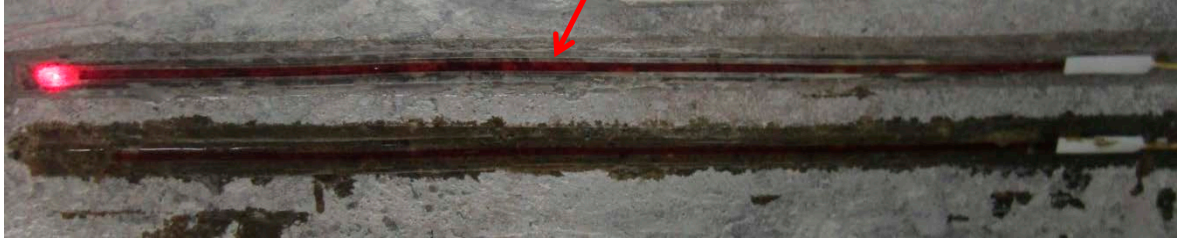
写真 5.6 光ファイバセンサ部の剥離状況の例 (2015 年 10 月 26 日、主立坑付近計測点)
