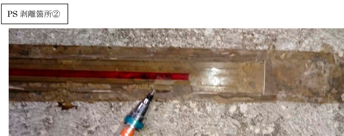
写真 5.5 PS 接着箇所の剥離部分の拡大写真 (2015 年 8 月 4 日、立坑間（避難所）計測点)
