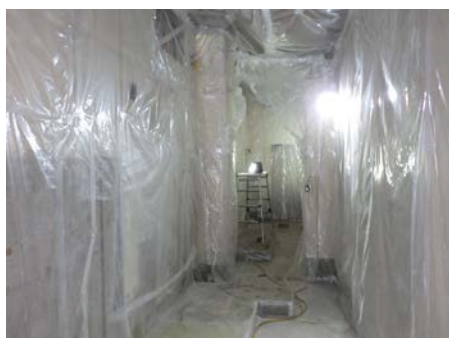
排風機室内（排気フィルタ撤去後）
