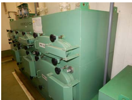
排気フィルタ（撤去前）
