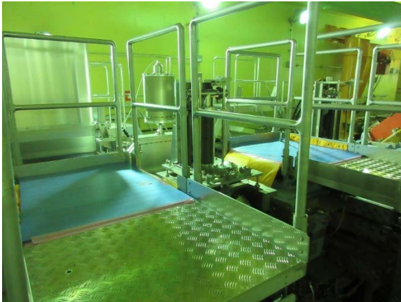
図 6.2-1 作業台上に設置した鉛マット（黄色）
