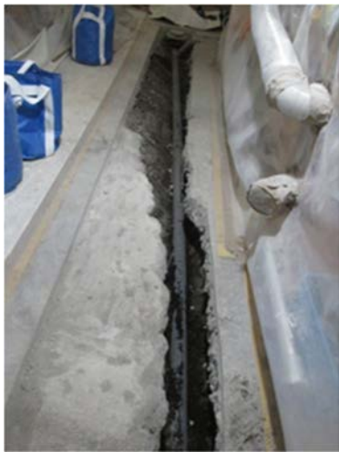
(3) 図面と異なる配管の例 (斜めに走る配管)
