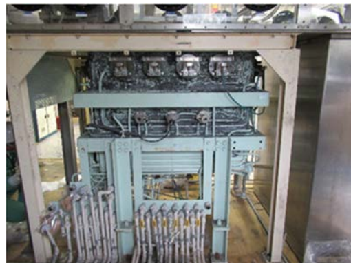
(2) 焼結炉に接続された冷却水配管
