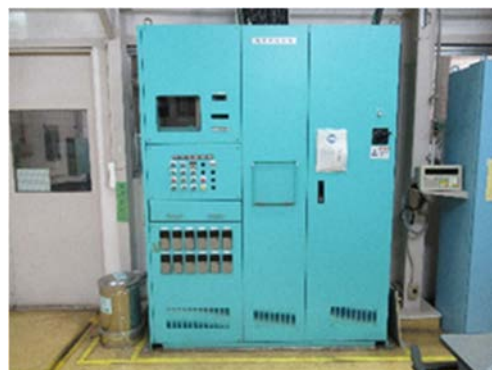
(2) 解体撤去前の制御盤及び操作盤②
