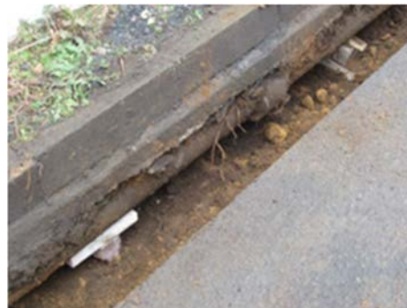
(6) 図面と異なる配管の例② (建屋下に入り込む配管)
