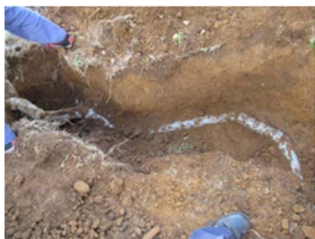
(5) 図面と異なる配管の例① (複雑な曲がり)
