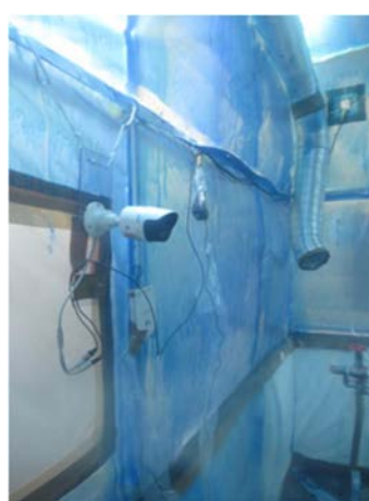
(6) 監視カメラの設置
