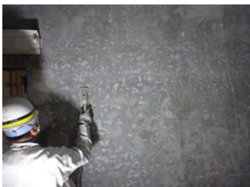
(5) 壁の汚染検査②
