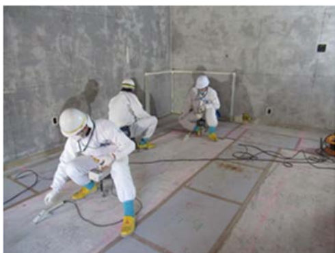
(1) 床の汚染検査①
