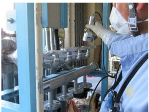
(3) 二次冷却水配管（汚染検査）
