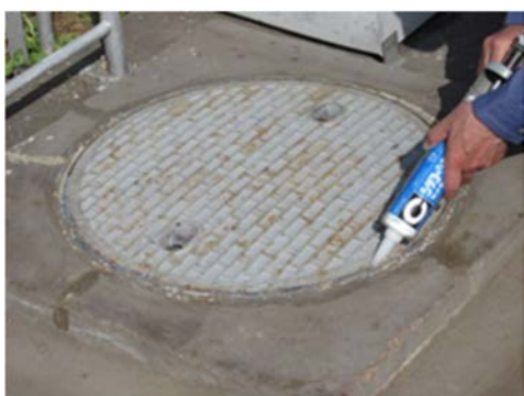
(5) 雨水侵入対策①
