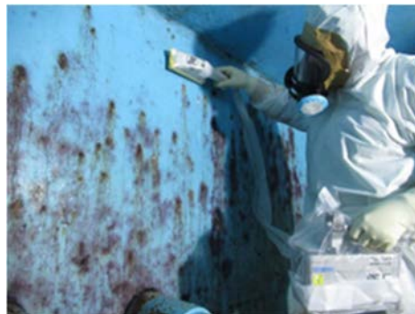
(2) 屋外排水受槽内部の汚染検査①
