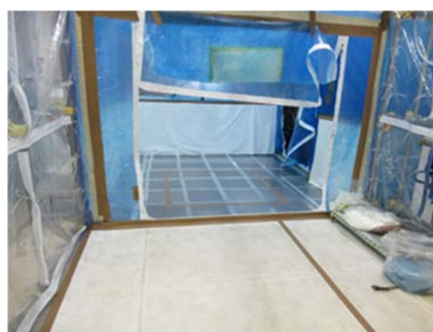
(4) コンテナ室及びコンテナサーベイ室
