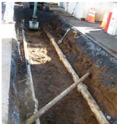
(3) 図面に無い配管等の例①
