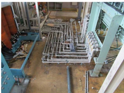
(1) 一次（ホット）・二次（コールド） 冷却水配管
