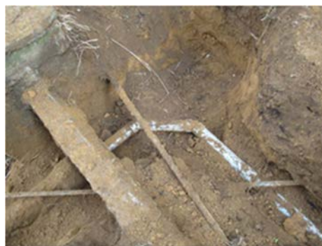
(4) 図面に無い配管等の例②
