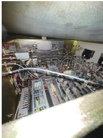
図 42：上部制御盤内
