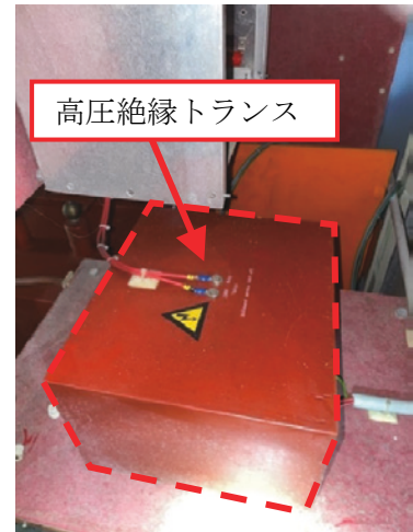
図 23：高圧絶縁トランス
