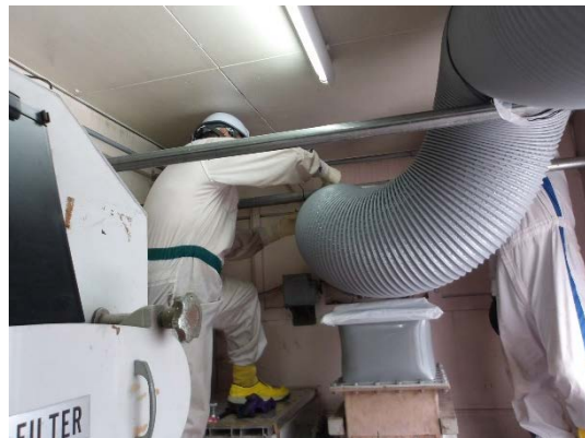
排気筒への二次側（排気）ダクト接続 （排気機械場）
