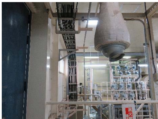
廃水処理室（部屋）東側電線ラック(1)
