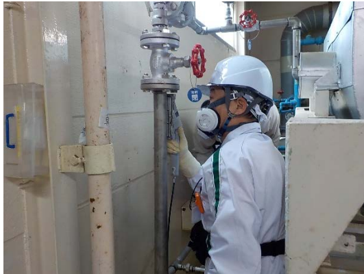
乾燥機配管（冷却水・蒸気等）
