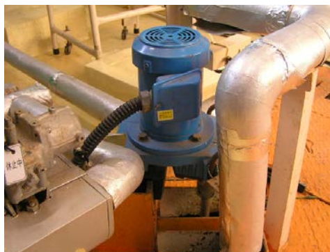
中和槽攪拌機
