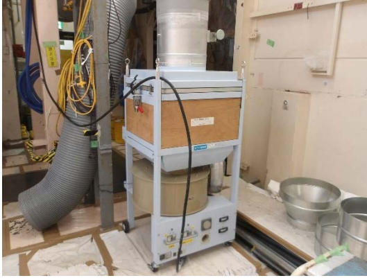
仮設排気装置外観
