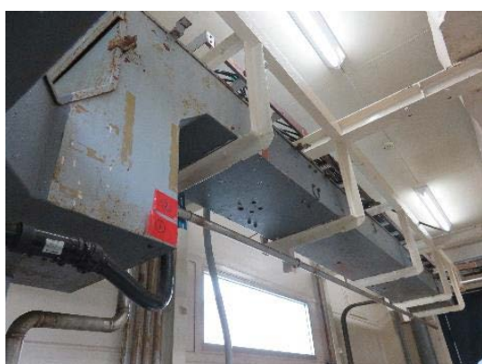
廃水処理室（部屋）北側電線ラック
