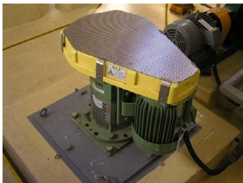
原水槽攪拌機
