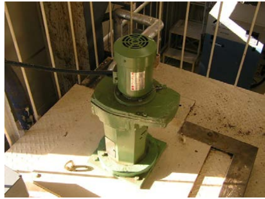
反応槽攪拌機
