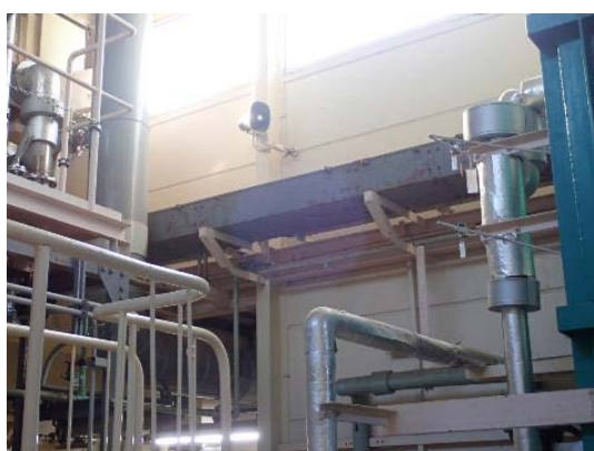
廃水処理室（部屋）西側電線ラック(1)
