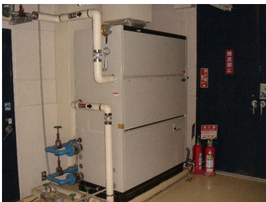
空調機撤去前
