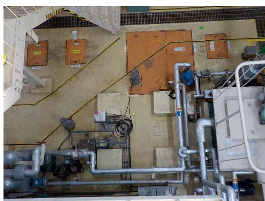
廃水処理室（部屋）各機器の電気配線
