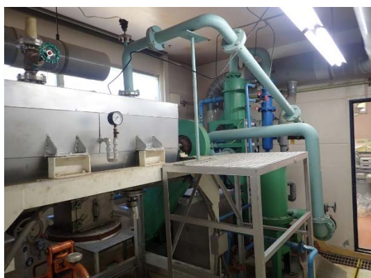
乾燥機配管（冷却水・蒸気等）
