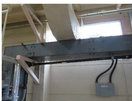
廃水処理室（部屋）西側電線ラック(2)
