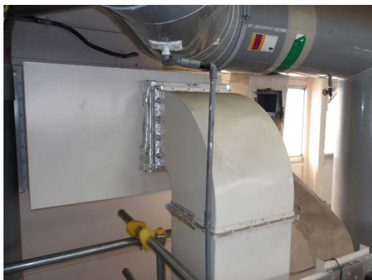
給気口（外気吸入口）及びダクト
