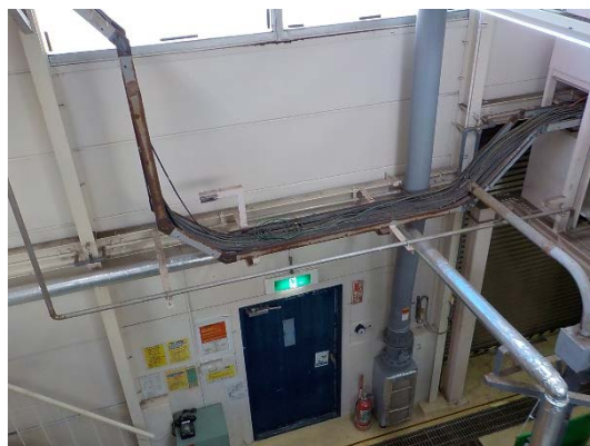
廃水処理室（部屋）東側電線ラック(2)
