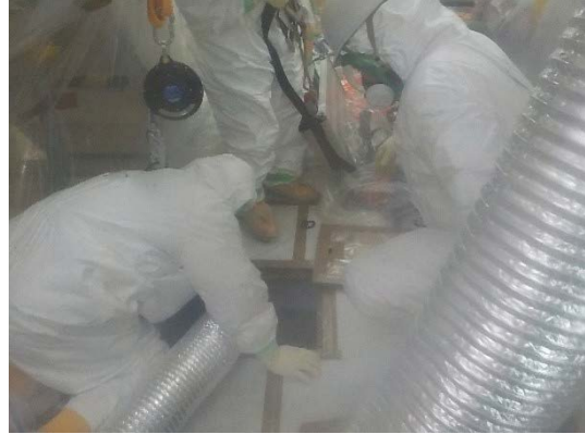
地下ピット内換気
