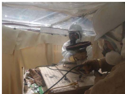
汚泥槽付属設備（攪拌機）解体撤去 （簡易ハウスⅢ作業エリア）
