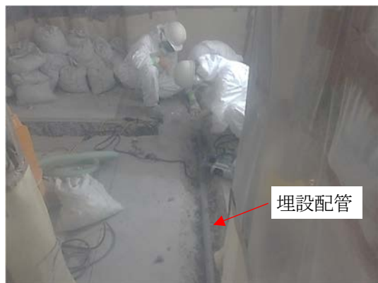
埋設配管の切断
