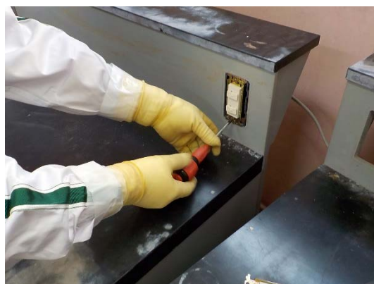
分析台コンセントの末端処理
