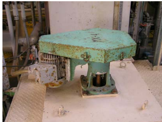
汚泥槽攪拌機
