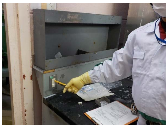
分析台コンセントの検電
