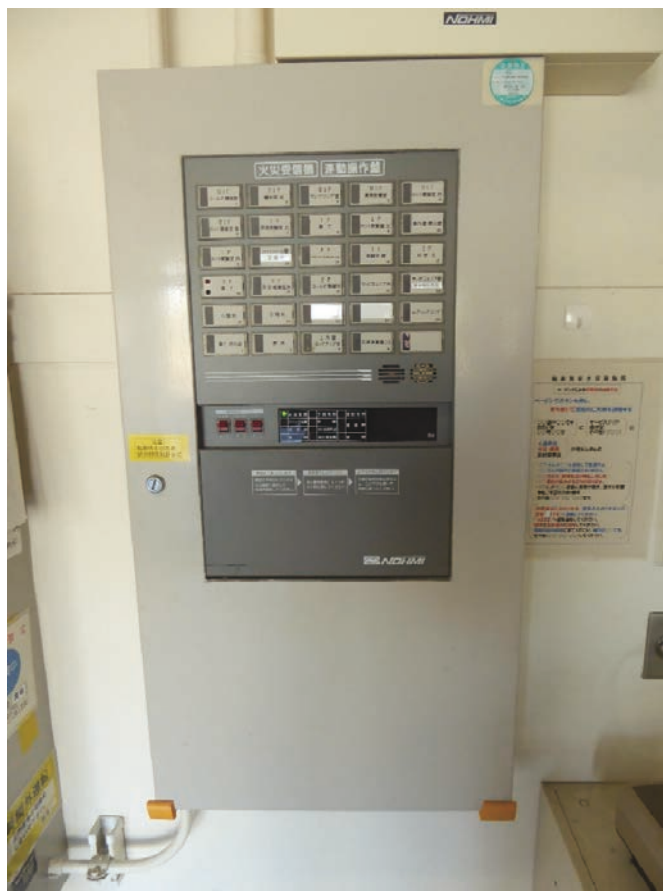
Photo 3.2.1 既設火災受信盤撤去前
