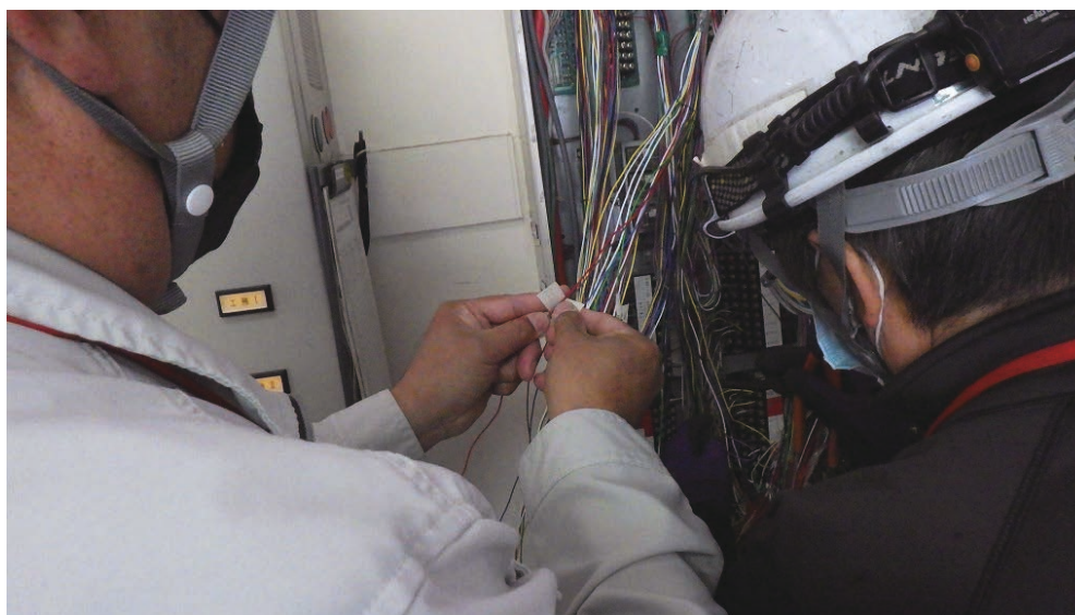
Photo 3.2.4 配線状況確認
