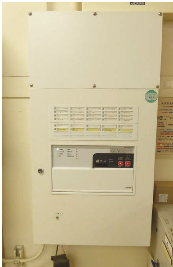
Photo 3.3.4 新規火災受信盤の設置状況
