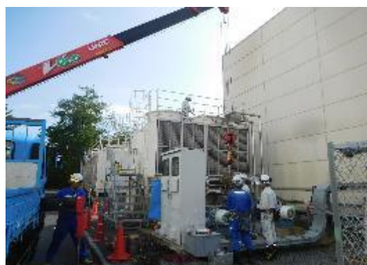
Photo 4.6 水ポンプの開放点検
