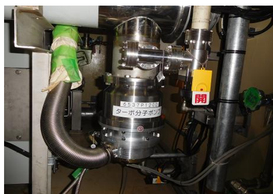
Photo 4.11 ターボ分子ポンプ
