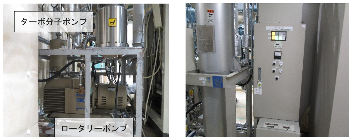
Photo 6.1 ヘリウム置換用真空ポンプと運転操作盤
