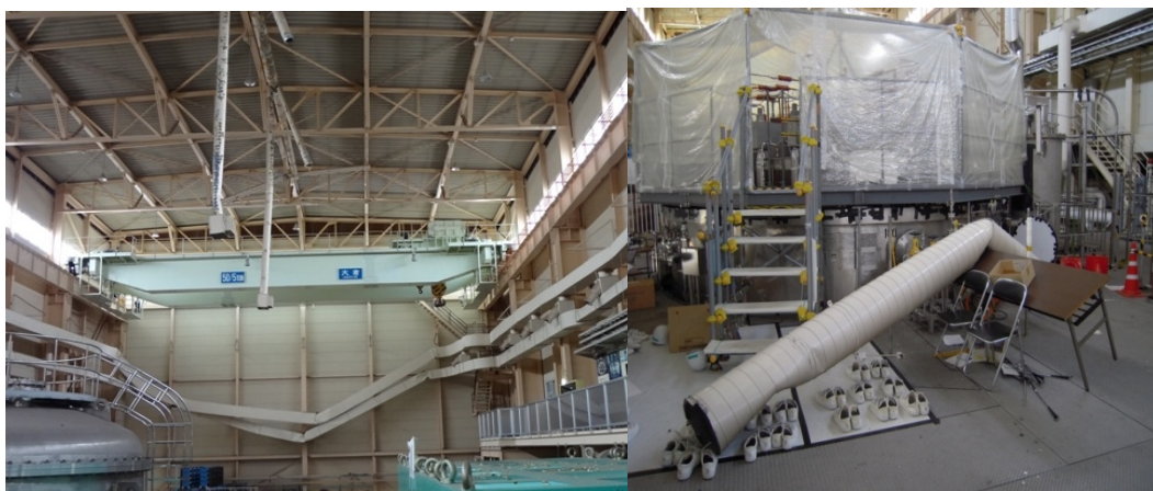
天井及び側面部空調ダクトの損傷、落下
