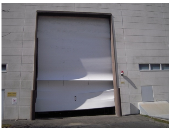
シャッターの損傷
