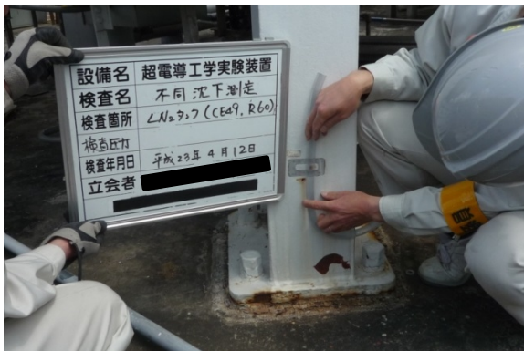
不同沈下測定 液体窒素貯槽(CE49)
