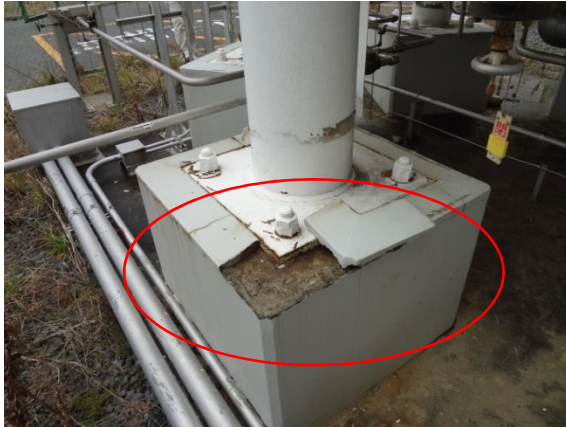
基礎化粧モルタル部の損傷 液体窒素貯槽(R60)
