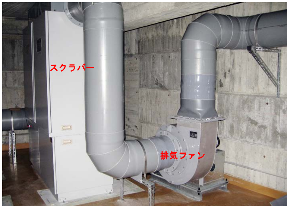
図 3.5 スクラバー及び排気ファン（機械室）の外観写真
