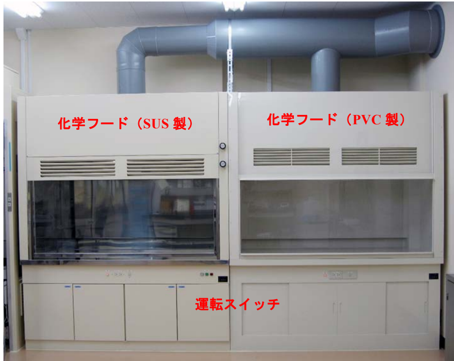
図 3.4 化学フード（化学実験室）の外観写真
