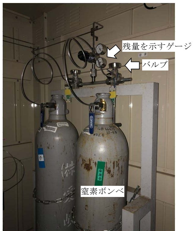
図 6.3 ボンベ庫内の窒素ボンベ
