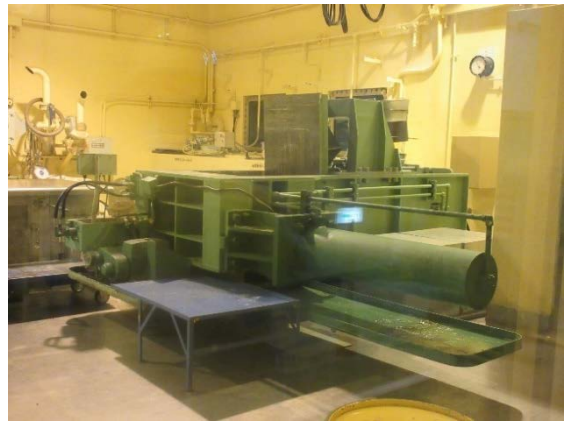
(j) α 固体廃棄物 A 圧縮装置
