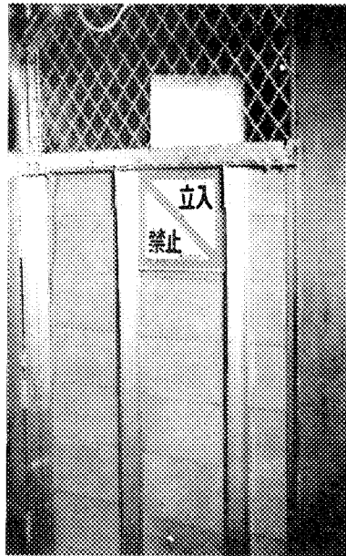
Fig. 6.4 サブバイル室内の遮断
