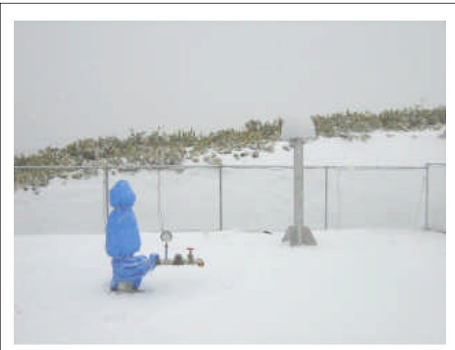
施工後：GPS アンテナ架台 装置全影
