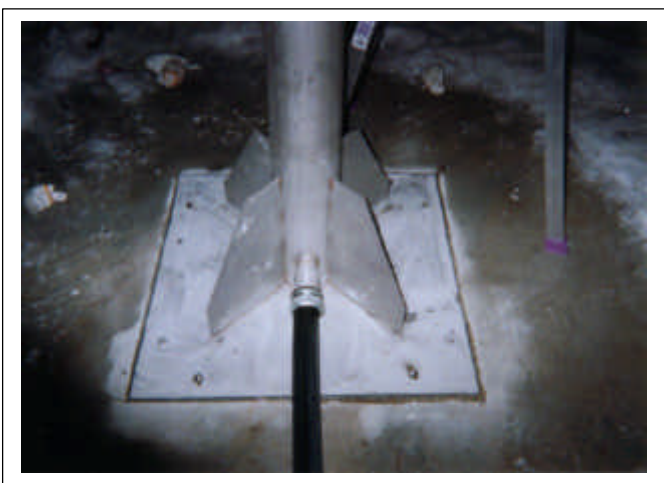
施工後:GPS アンテナ設置 装置設置周囲 シリコンコーキング
