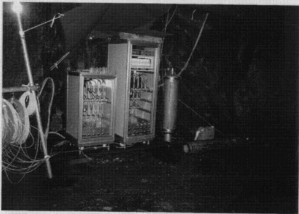
写真-22 計測部増設部分
