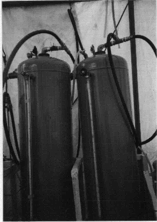
アキュムレーター（大）接続状況及び水位計
