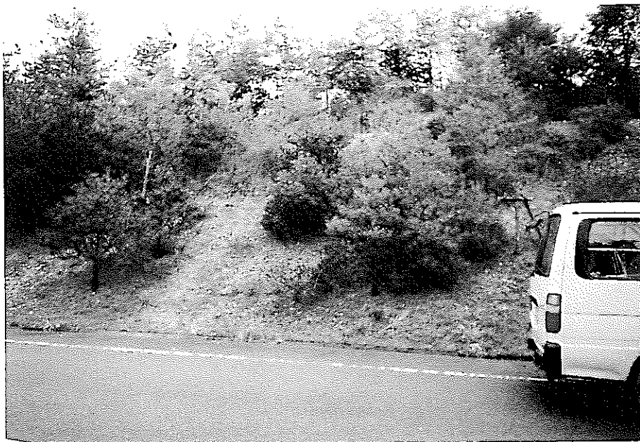
写真-10 測線距離230m付近の切土法面（土岐砂礫層） 測線位置は法尻
