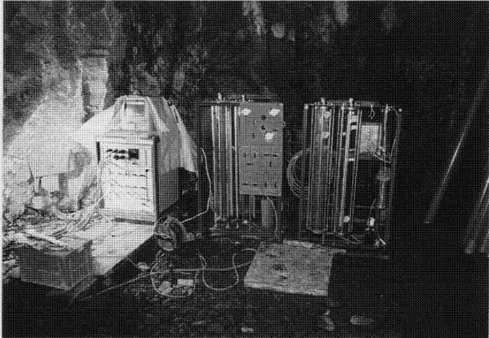
写真-3 記録装置、流量計ユニット、定水圧制御装置
