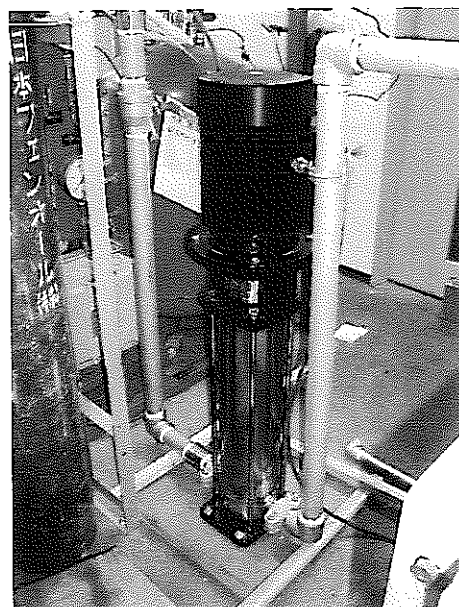
写真 2. 3-4 水噴霧用ポンプ
