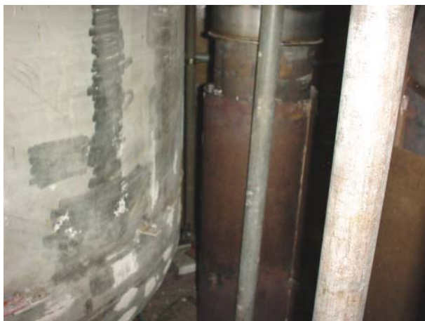
ポンプ洗浄槽と旧主中間熱交換器 (A)2 次側配管との据付ギャップ (約 56mm)
