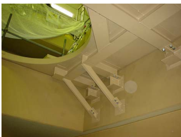
ポンプ洗浄槽及び遮へい体支持架台
