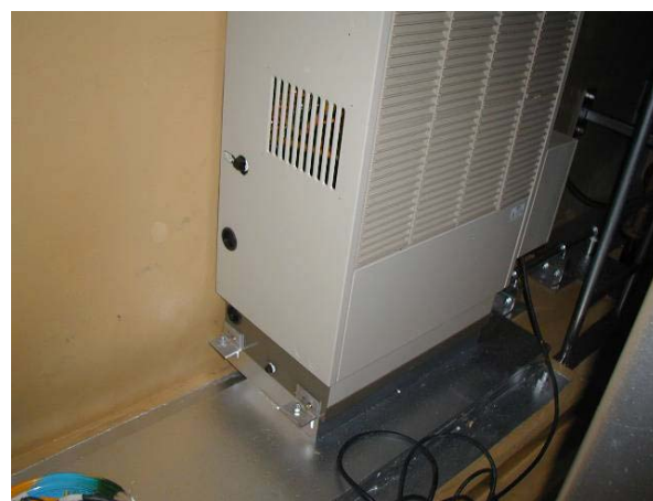
室内結露防止のための除湿機
