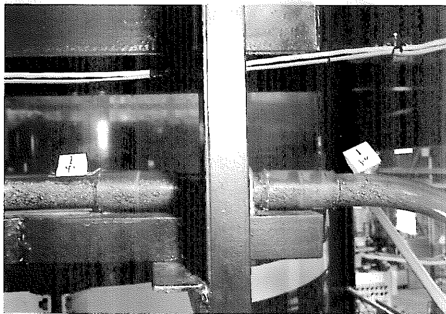
図3-36 (b) 配管部1のスラッジ堆積状態
