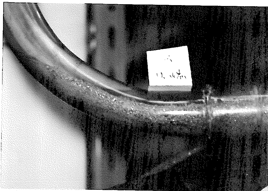
図3-26(g) 配管部3のスラッジ堆積状態
