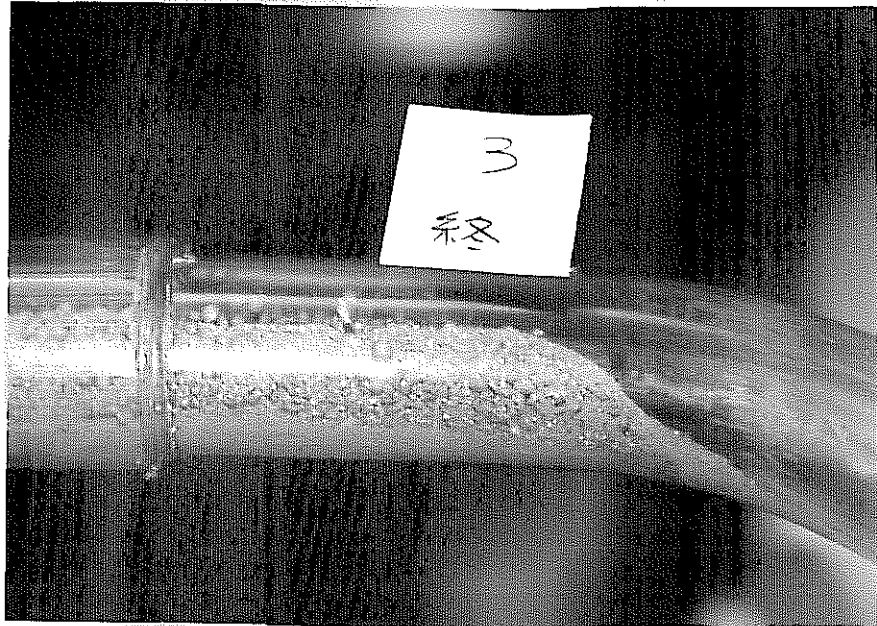
図3-26(i) 配管部3のスラッジ堆積状態
