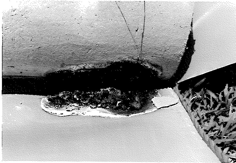
写真 55、試験番号 8 配管下部 保温材外への漏れ
